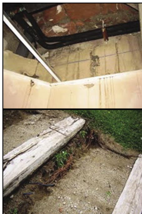
Detalls de falta de manteniment Foto: BO
